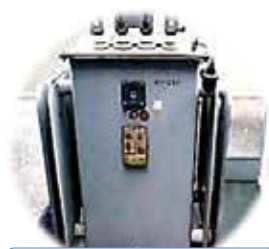
変圧器(トランス)
